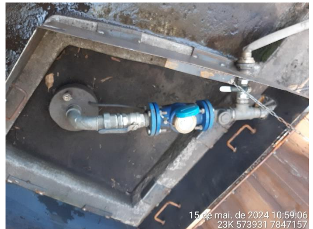
Foto 42: Caixa de alvenaria com tampa de aço do Poço artesiano 03, localizado na área operacional da empresa.
