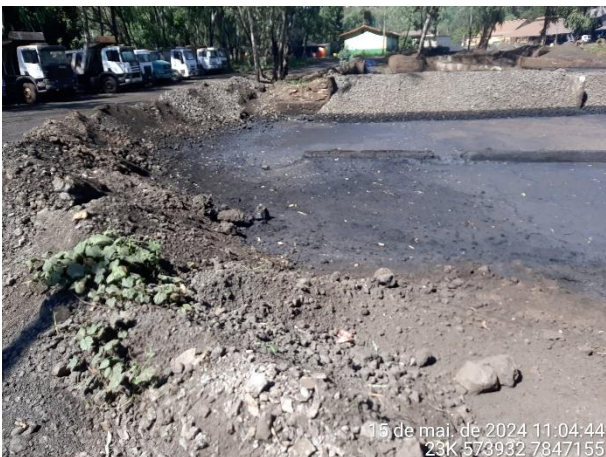
Foto 17: Leira de material implantada para contenção do pó de balão em decantação.
