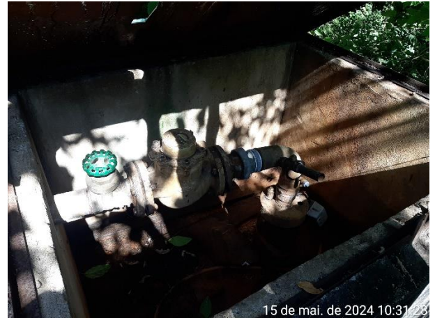
Foto 40: Detalhe interno da caixa na saída do Poço 02. Verifica-se o tubo de monitoramento, torneira e hidrômetro.
