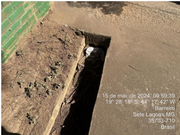
Foto 7: Canaleta de drenagem obstruída.
