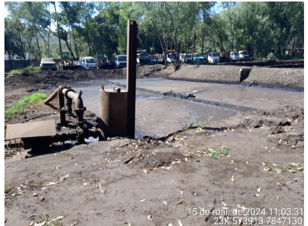
Foto 16: Bomba d'água instalada na baia para captação da água e retorno ao sistema de lavagem de gases.
