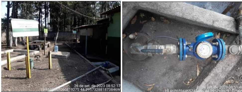
Figura 7. Local onde está instalado o Poço Tubular 03 e seu respectivo hidrômetro
