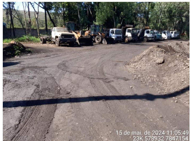
Foto 18: Acesso à área de operação localizado a jusante das baias de decantação, coberto com material semelhante ao pó de balão, caracterizando Indícios de extravasamento de pó de balão.
