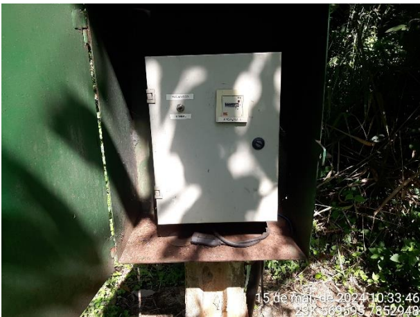
Foto 41: Horímetro do Poço 02.
