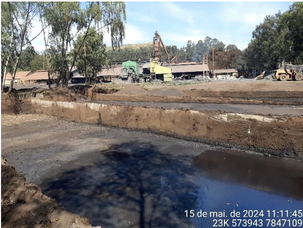
Foto 15: Baias de decantação de pó de balão.
