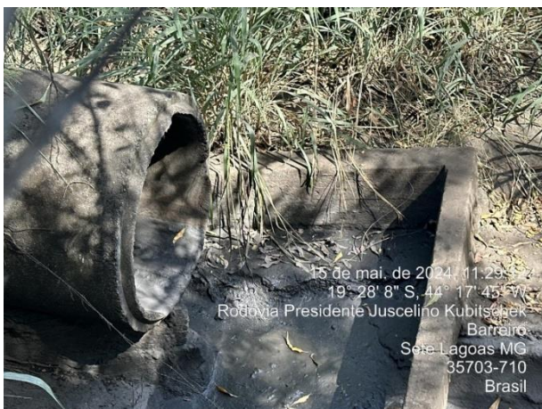
Foto 11: Ponto de lançamento dos efluentes pluviais e da CSAO, na área da empresa vizinha, com significativa quantidade de sedimentos e pó de balão.
