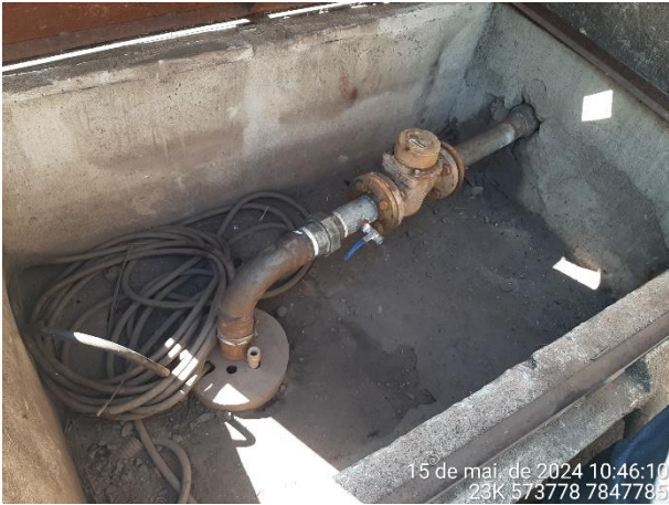
Foto 37: Detalhe interno da caixa na saída do Poço 01. Verifica-se o tubo de monitoramento, torneira e hidrômetro.
