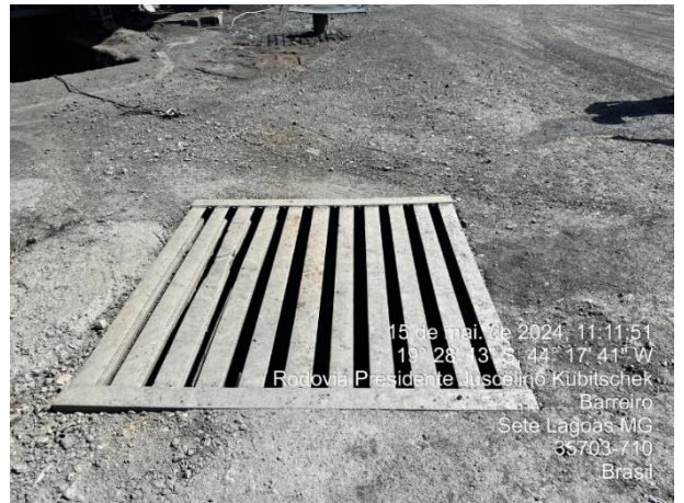
Foto 62: Caixa de passagem de efluentes de água pluvial.
