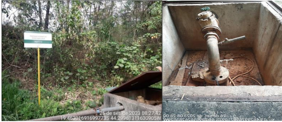
Figura 6. Local onde está instalado o Poço Tubular 02 e seu respectivo hidrômetro
