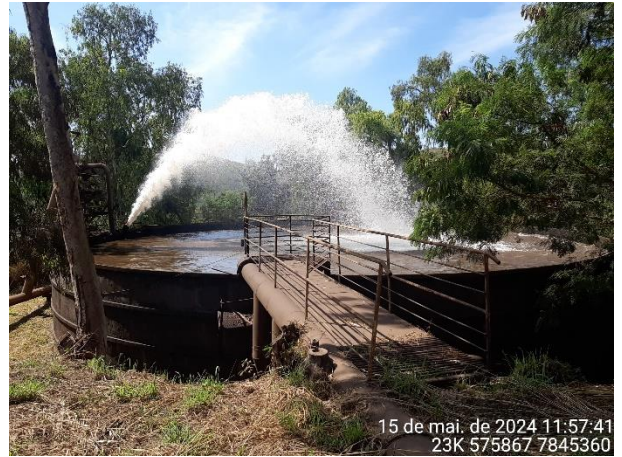
Foto 44: Tanque de resfriamento e recebimento de água nova.
