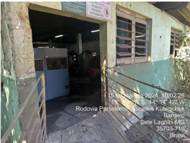
Foto 23: Sala dos compressores, com evidência de geração de efluente líquido no piso.
