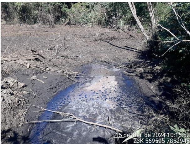
Foto 21: Detalhe das condições em que se encontra o referido lago.
