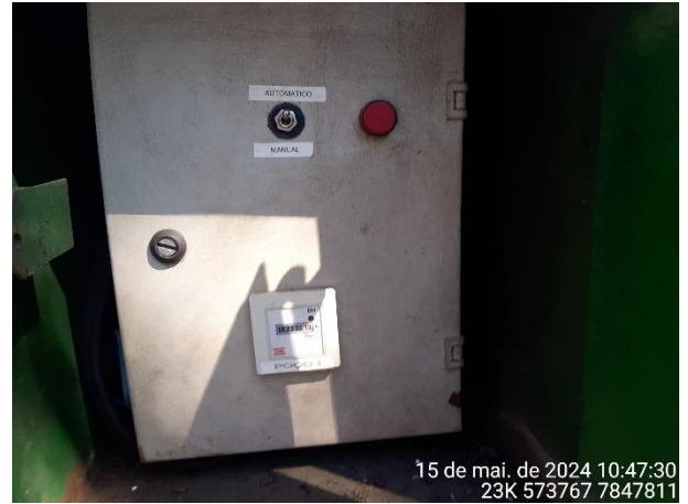
Foto 38: Horímetro do Poço 01.
