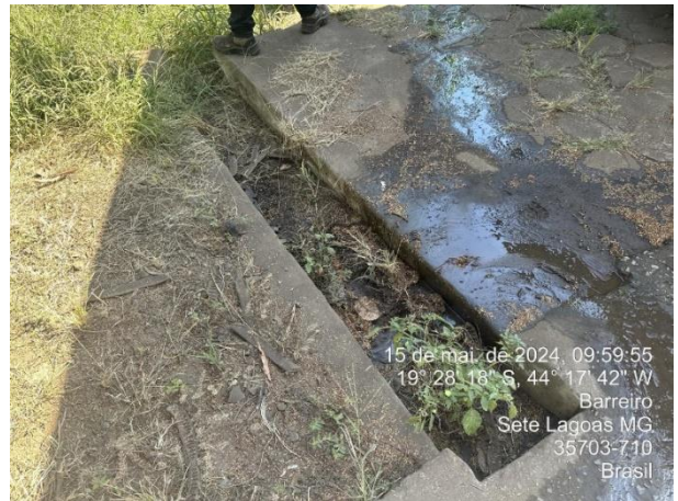
Foto 8: Canaleta de drenagem repleta de sedimento, condição que impossibilita o escoamento de água.
