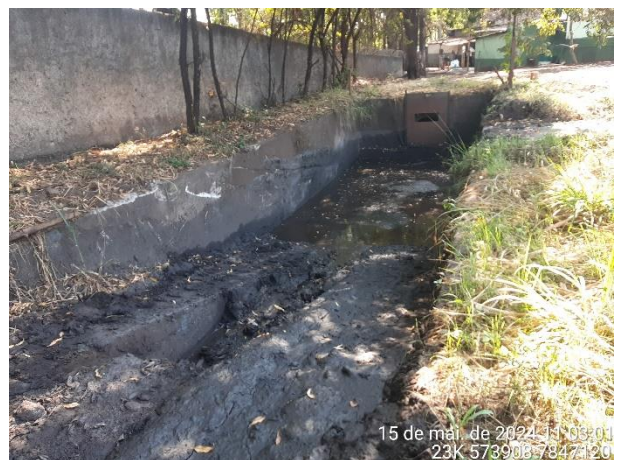
Foto 10: Bacia de contenção de sedimentos localizada no final do sistema de drenagem (coordenadas UTM 23K 573905 / 7847128).
