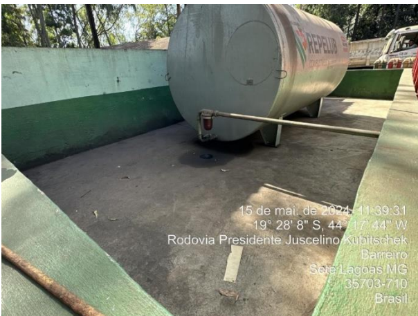
Foto 35: Tanque de combustível, contido em caixa de alvenaria impermeável com vazamento.
