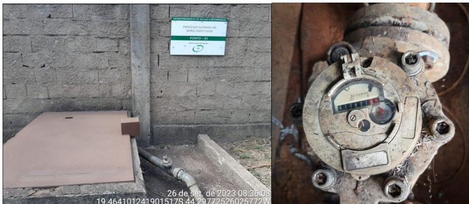
Figura 5. Local onde está instalado o Poço Tubular 01 e seu respectivo hidrômetro
