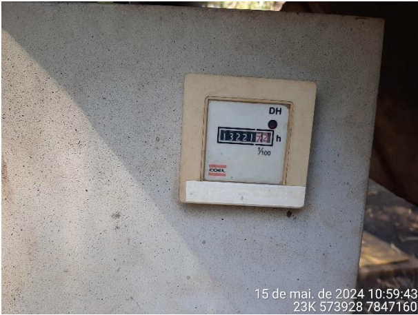
Foto 43: Horímetro do Poço 03.
