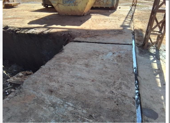
Foto 04: Canaletas para captação de efluentes (galpão de blindagem de resíduos)
