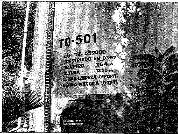
Foto 07 – TQ 501. Água para combate a incêndio
