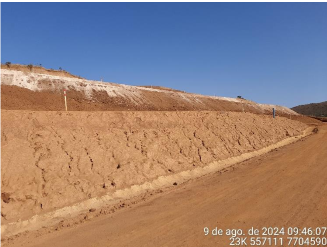
Foto 19: Talude ao longo do acesso ao escritório com formação de diversos processos erosivos.
