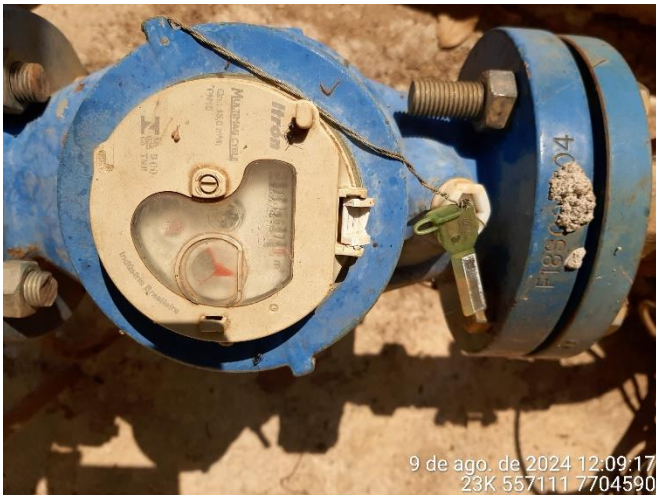
Foto 79: Hidrômetro do poço 01.
