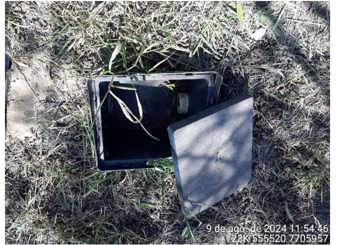
Foto 48: Saída de efluente da fossa séptica do refeitório da cava 97. Constatando que não está em uso, com compartimento seco.
