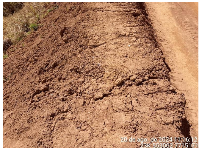
Foto 22: Rachaduras nas leiras ao longo acesso próximo à UTM.
