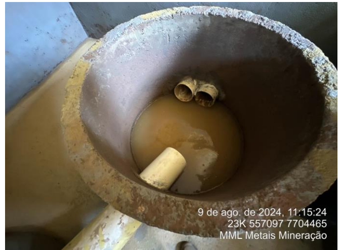
Foto 38: Saída dos efluentes pós separação na CSAO da oficina mecânica e posto de combustível.
