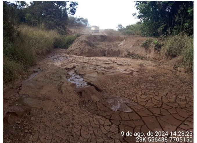
Foto 74: Sump a montante da ponte do córrego Fartura que recebe o escoamento superficial do acesso à Cava 97.
