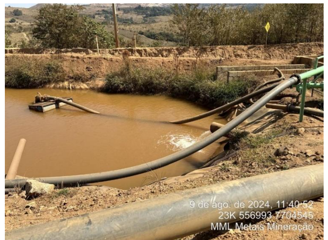
Foto 40: Sistema de captação da água de reuso.
