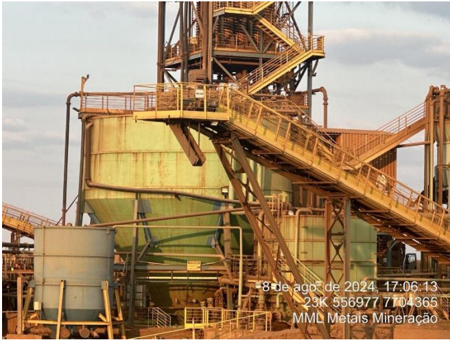
Foto 23: Tanques espessadores de rejeito.
