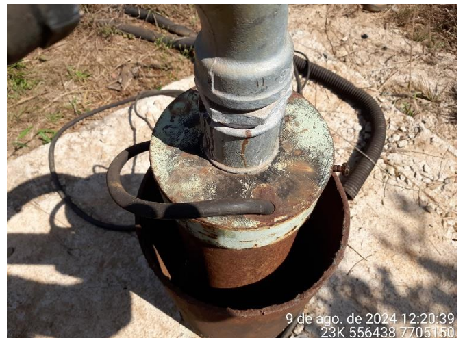
Foto 88: Poço sem o tubo de monitoramento estático.
