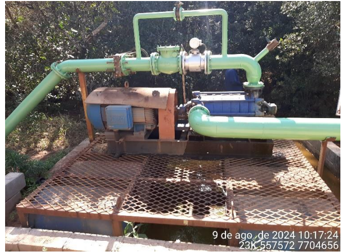
Foto 96: Sistema de bomba com motor elétrico instalado em balsa.
