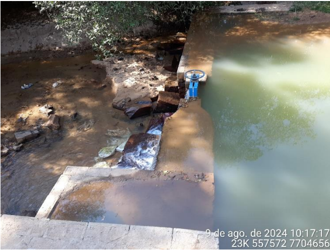
Foto 95: Barramento de alvenaria no córrego Olaria, para reservação de água para bombeamento.
