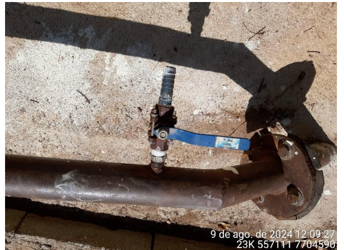
Foto 80: Torneira de monitoramento do poço 01.
