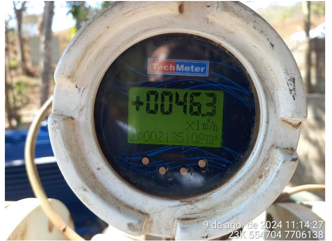
Foto 90: Hidrômetro do ponto de captação P04.
