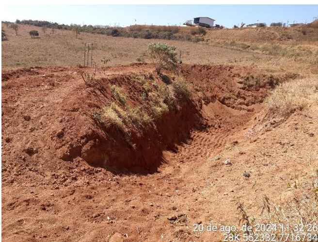
Foto 75: Sump 19 instalado em área vizinha fora da propriedade da MML.
