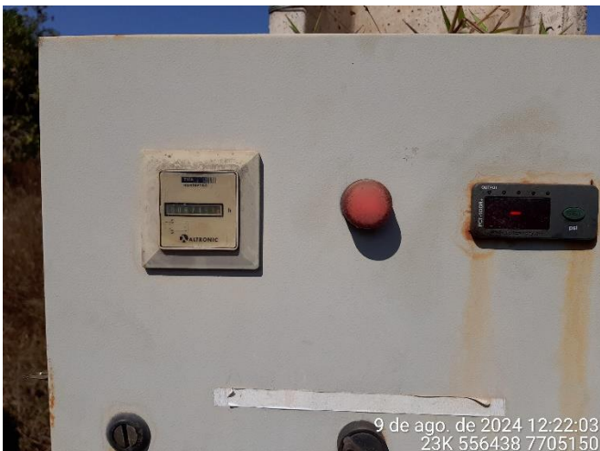
Foto 87: Horímetro do poço 02.
