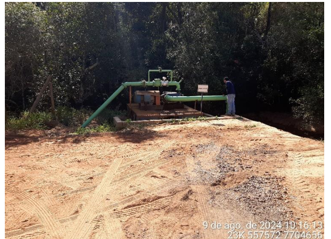
Foto 94: Área da captação com sistema de bombeamento do ponto P05.
