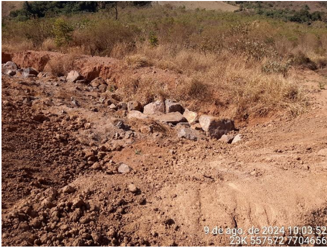
Foto 101: Estrutura de sump semelhante ao que foi implantado dentro da área de reserva legal da matrícula 13.675.
