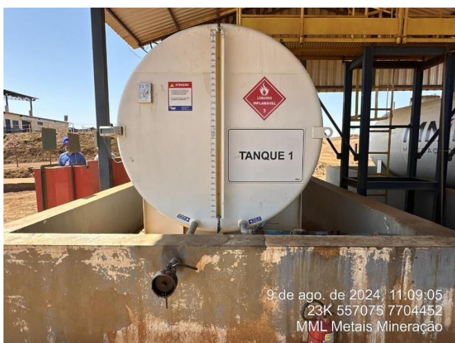
Foto 57: Tanque de combustível 01 – Diesel.
