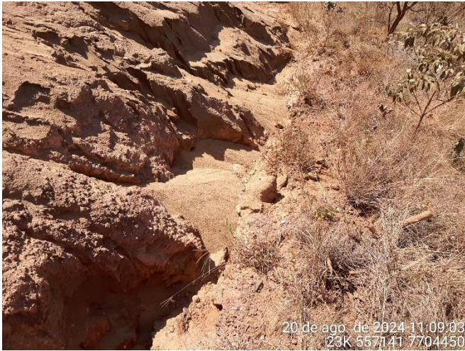
Foto 71: Porção da pilha de estéril onde pode ser evidenciado o carregamento de sedimento para a vegetação vizinha. Ponto localizado nas coordenadas UTM 23k 556983 / 7704041.
