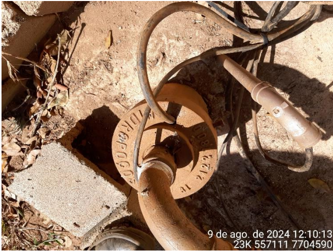
Foto 83: Poço sem o tubo de monitoramento estático.
