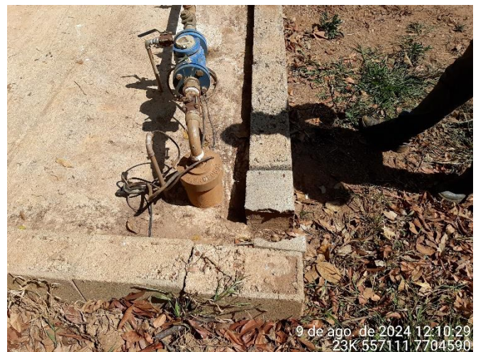
Foto 82: Área impermeabilizada do poço 01 não possui 1,0m² ao redor do poço.
