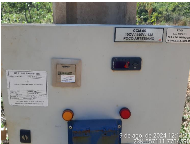
Foto 81: Horímetro do poço 01.
