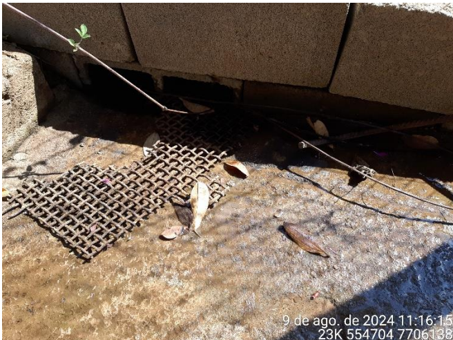
Foto 93: Efluente escorrendo para fora da área pavimentada e contaminando o solo na área externa.
