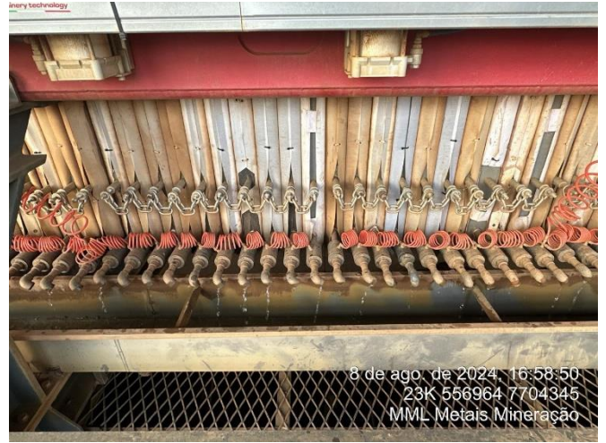
Foto 24: Placas filtrantes em operação no filtro-pressa.
