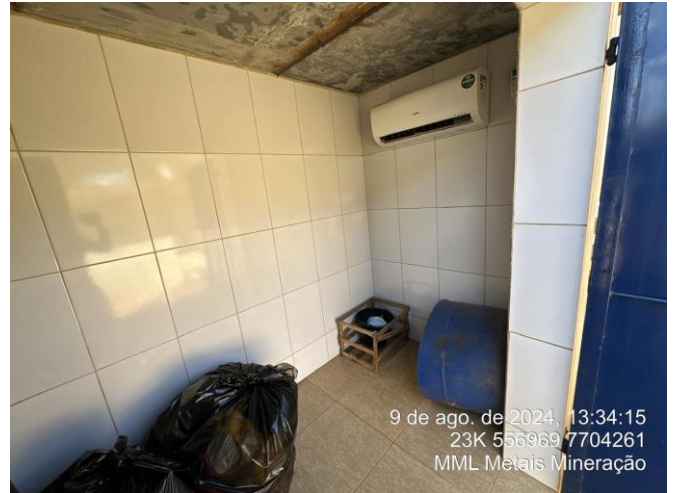
Foto 36: Possível observar o ar-condicionado para climatizar área de acondicionamento dos resíduos Classe II, para evitar proliferação de insetos
