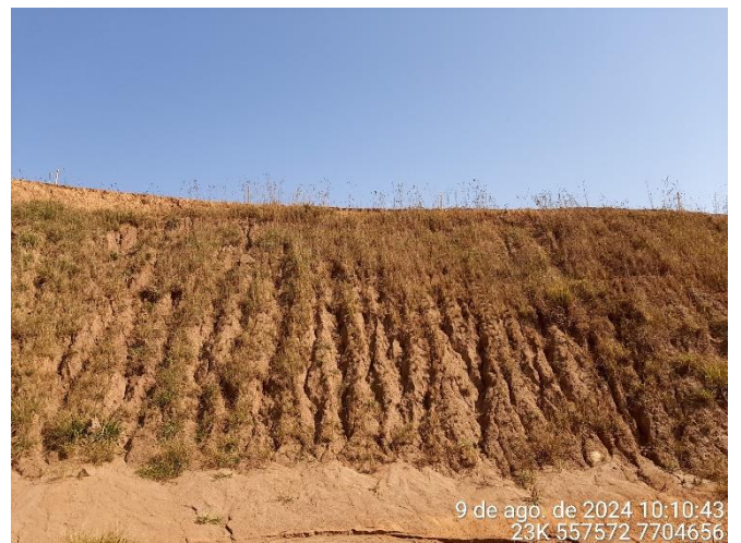
Foto 16: Talude revegetado, mas com formação de processos erosivos.
