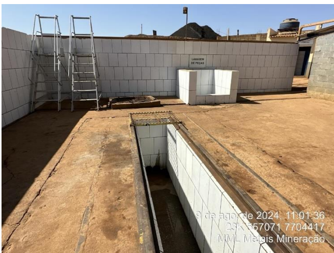
Foto 51: Área do lavador de veículos.
