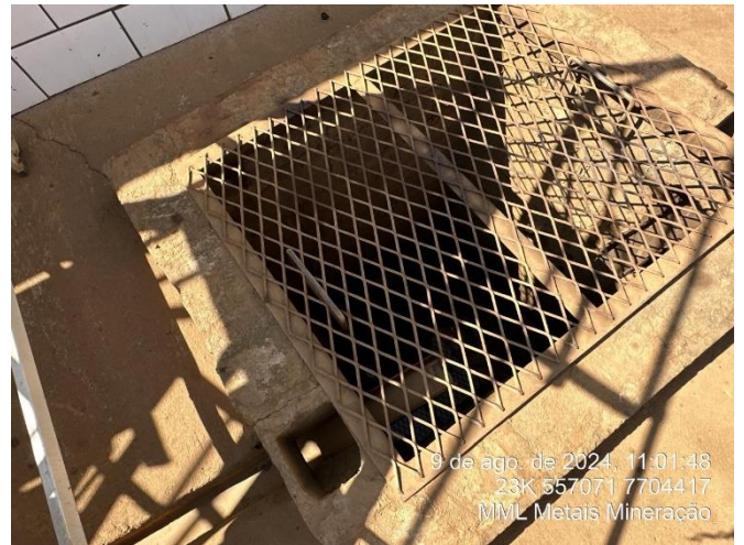
Foto 54: Caixa de passagem para retenção de sedimentos, entre a área do lavador de veículos e a CSAO associada.
