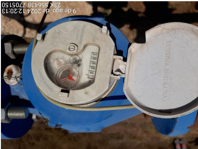
Foto 85: Hidrômetro do poço 02.
