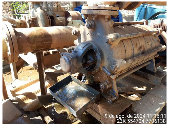
Foto 92: Evidência de vazamento de óleo no eixo da bomba.
