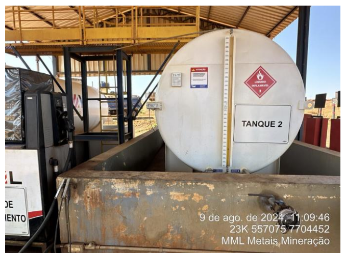
Foto 58: Tanque de combustível 02 – Diesel.
