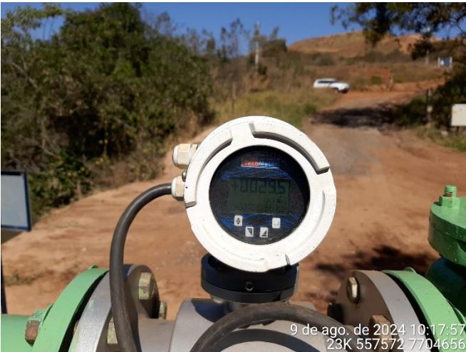
Foto 97: Hidrômetro instalado na tubulação do ponto de captação P05.
