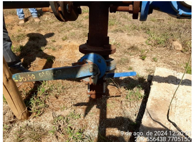
Foto 86: Torneira de monitoramento poço 02.
