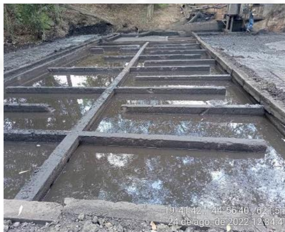
Foto 04. Tanques para recirculação de água
