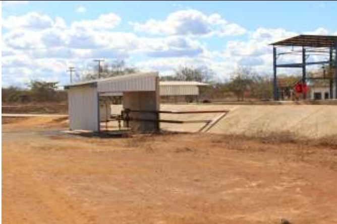
Foto 5: Sistema de Combate a Incêndio
