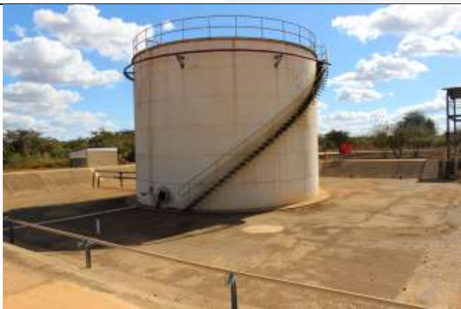
Foto 1: Tanque de Combustível e Dique de Contenção
