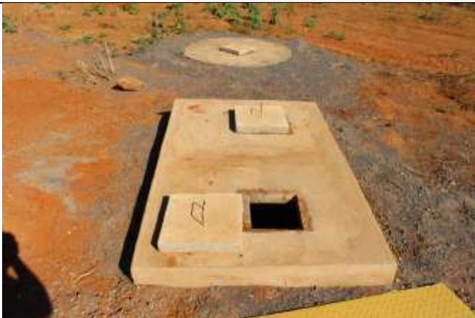
Foto 7: Tratamento Sanitário de Efluente
