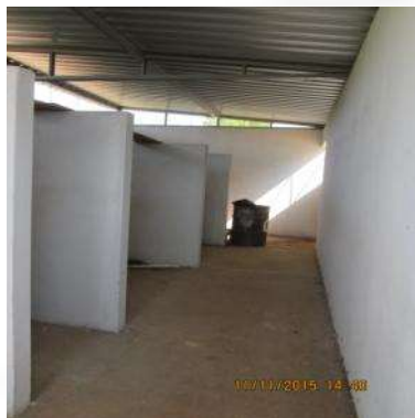
Figura 12: Depósito temporário de resíduos.
