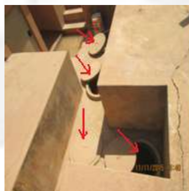
Figura11: Sistema de Caixa SAO do lavador de veículos.
