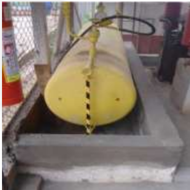
Figura 1: Tanque de amônia com bacia de contenção
