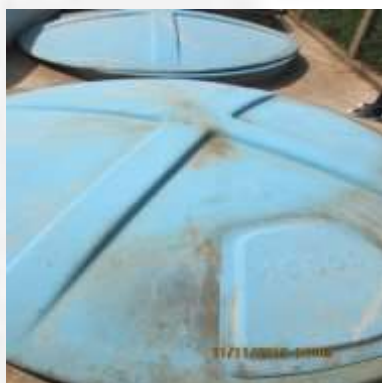
Figura 8: Tanques de equalização.
