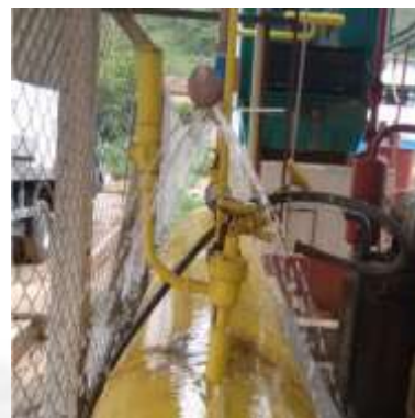
Figura4: Chuveiro instalado sobre o tanque de amônia.
