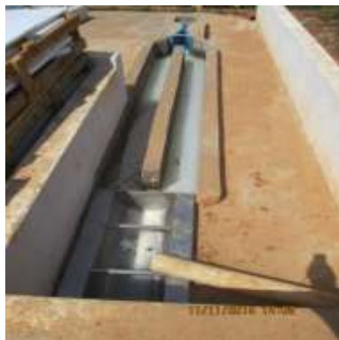
Figura 6: Entrada do sistema da ETE
