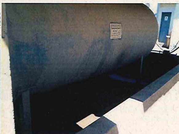
Figura 4. Tanque de combustível com bacia
