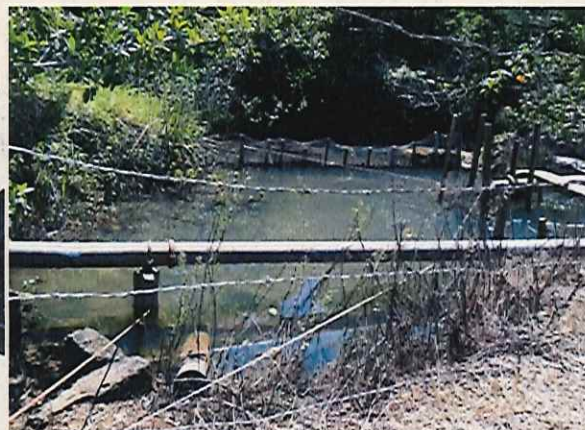
Figura 8. Ponto de captação superficial
