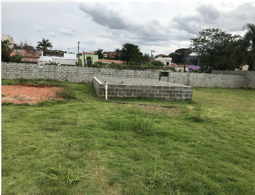
Estruturas em Área de Preservação Permanente – APP, tanque de equalização
