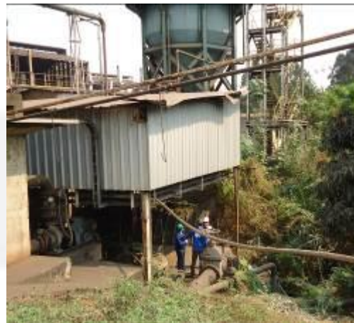
Foto 02. Captação superficial de água.
