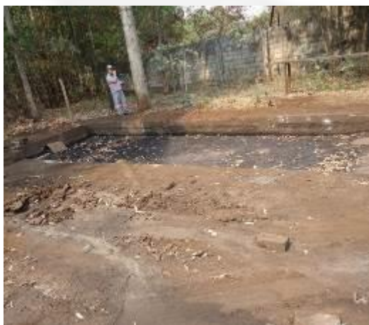
Foto 11. Tanque de decantação de efluentes pluviais assoreado.
