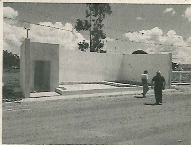
Figura 2: Área instalação Gerador.
