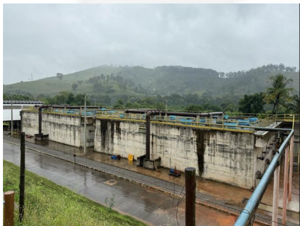
Foto 03: Reatores UASB (antigos) para tratamento secundário do esgoto.
