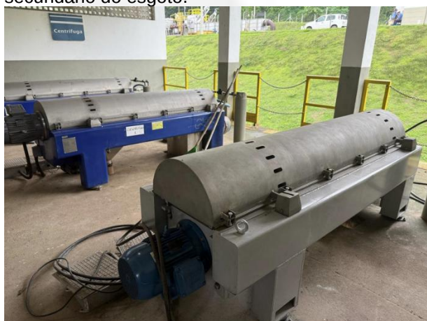
Foto 05: Centrifugas para desidratação do lodo.
