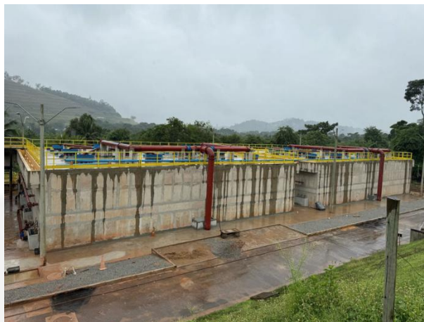
Foto 02: Reatores UASB (novos) para tratamento secundário do esgoto.
