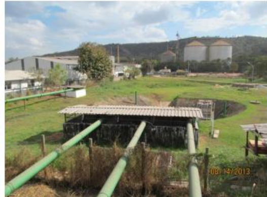
Foto 6 - Bacias para armazenamento de água em excesso e Estação de Bombeamento
