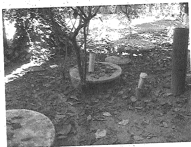
Foto 08. Fossa séptica, filtro e sumidouro
