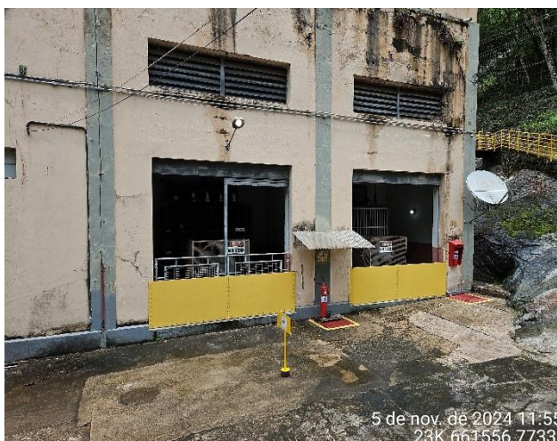
Foto 23: Cômodos com os transformadores da Casa de Força da CGH Salto.
