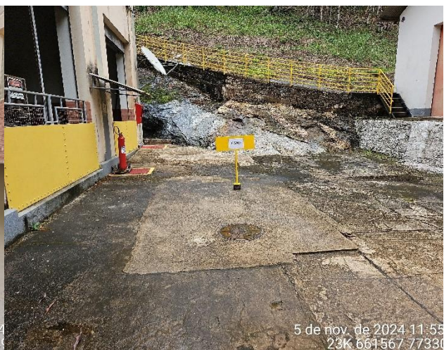
Foto 40: CSAO associada aos transformadores da CGH Salto.
