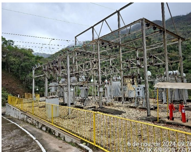
Foto 31: Subestação da CGH Caboclo.
