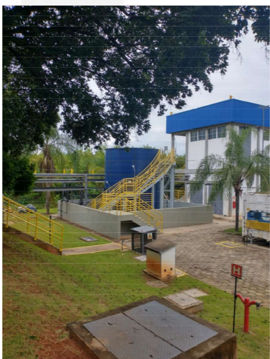
Foto 11 – ETE industrial e sanitária
