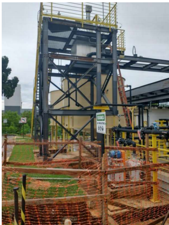
Foto 9 – ETE industrial e sanitária
