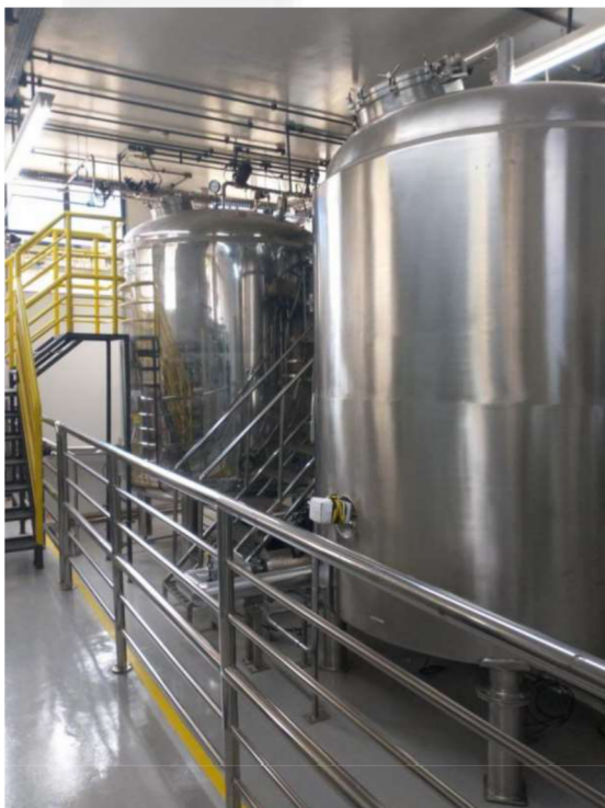
Foto 7 – Equipamentos da WFI - Bloco H
