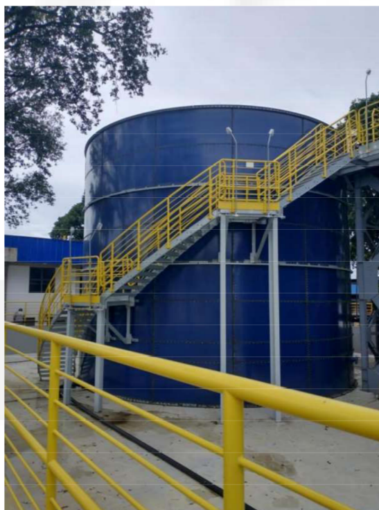
Foto 8 – ETE industrial e sanitária
