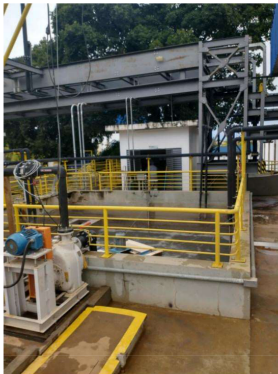
Foto 10 – ETE industrial e sanitária
