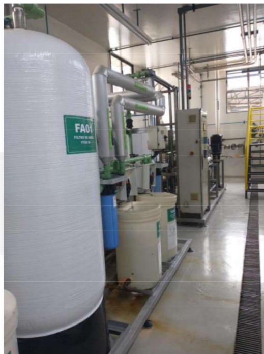
Foto 6 – Equipamentos da WFI - Bloco H
