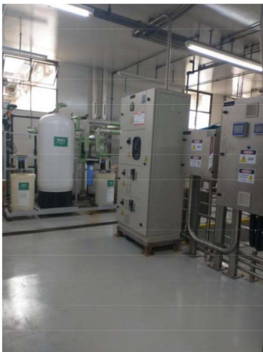
Foto 5 – Equipamentos da WFI - Bloco H
