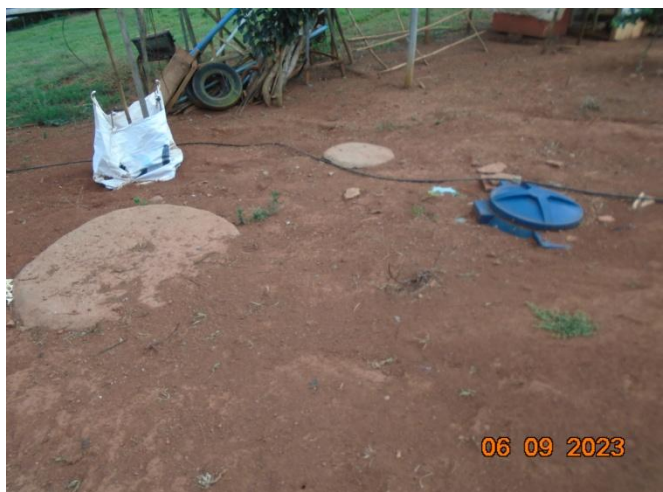
Foto 05: Fossa séptica instalada
