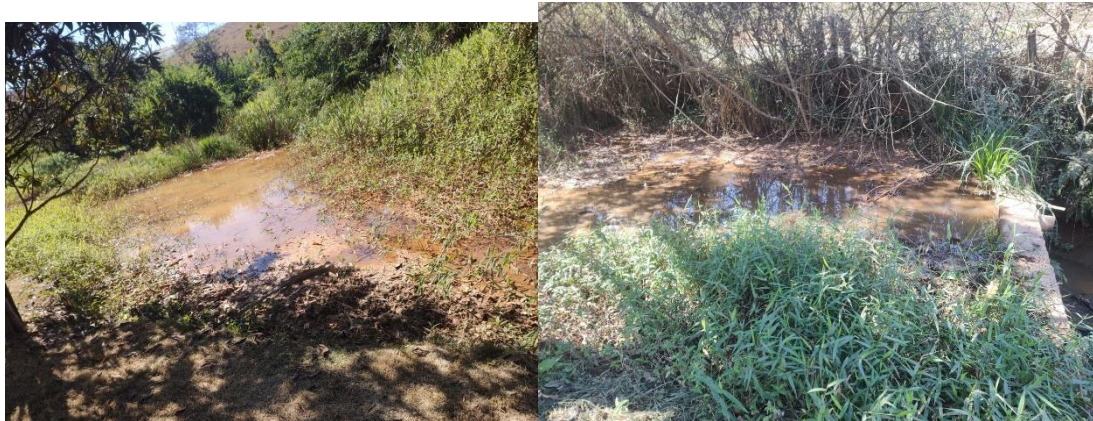
Foto 07 e 08: Área 5. Fonte Vistoria SEMA 26/07/2024.
