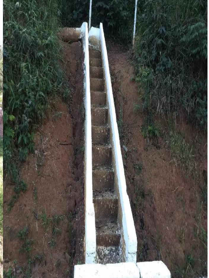
Figura 08: Sistema de drenagem pluvial do CPGRS.
