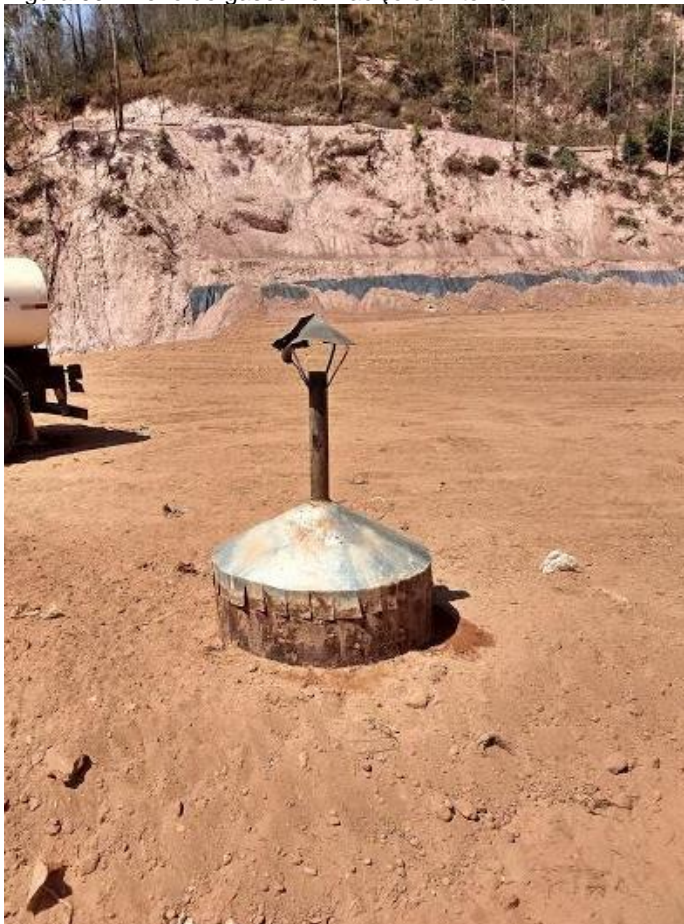
Figura 09: Dreno de gases no maciço do Aterro.
