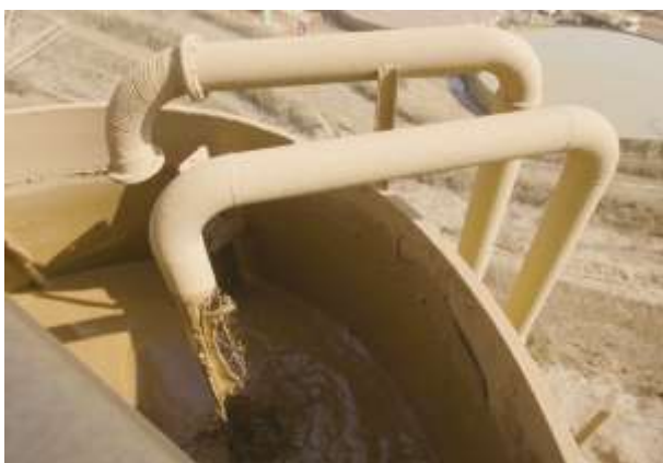
Figura 3 - Entrada da lama no espessador da filtragem
