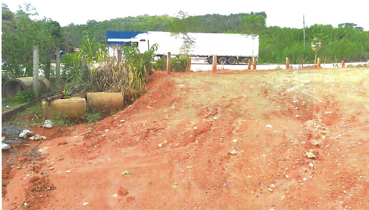
Foto 03: Destacando o aterro realizado e as ravinas presentes gerando sedimentos para a calha do córrego.
