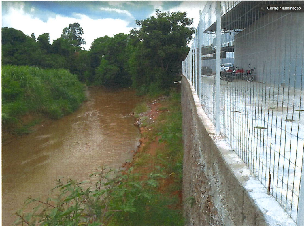
Foto 01: Foto do local evidenciado muro às margens do Ribeirão Ubá
