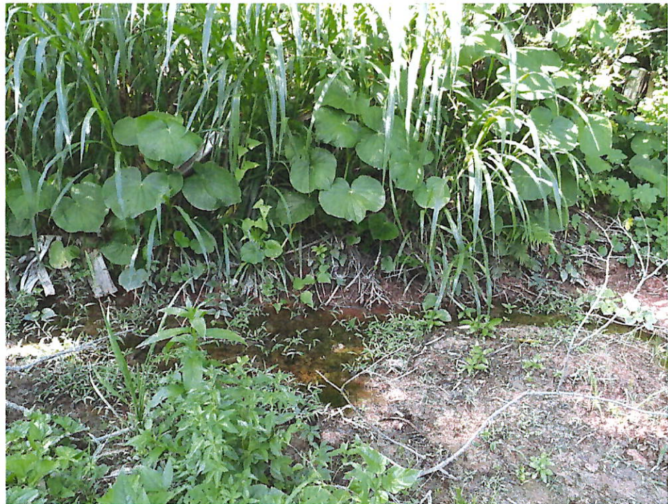
Foto 3- Zona úmida com presença de água na base do talude.
