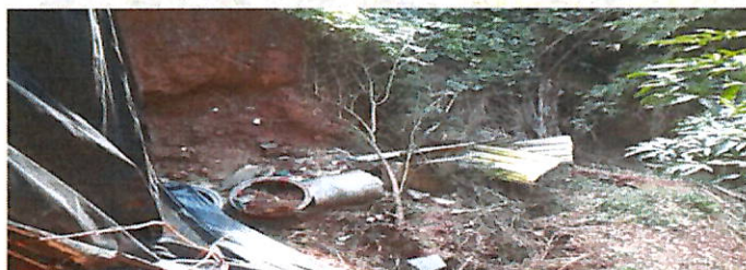
Foto 02- Localização do local da erosão causada pelas enchentes das últimas fortes chuvas do final do ano de 2019 e 2020. Coordenadas: 21°06'44,5" S 42°53'27,39" O
