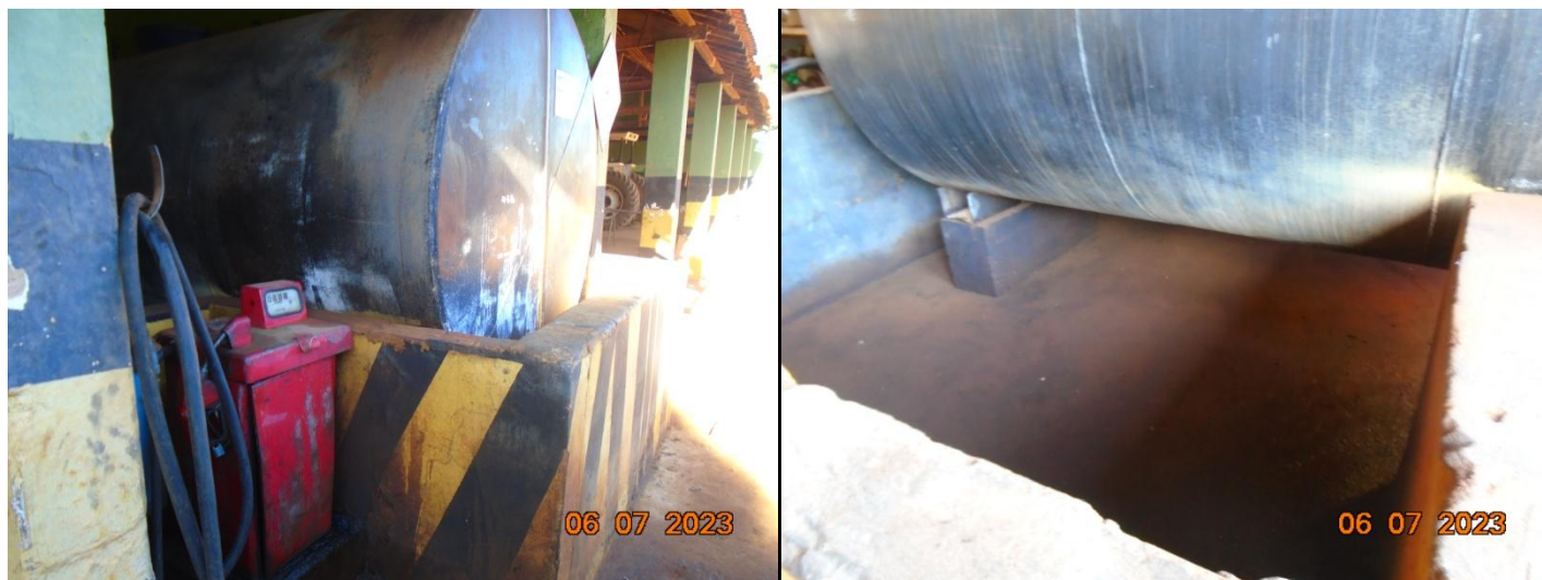
Figura 12 - Ponto de abastecimento em área impermeabilizada com bacia de contenção Fonte: SEMMA
