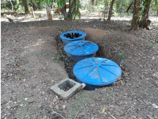
Foto 01: Tratamento efluentes domésticos
