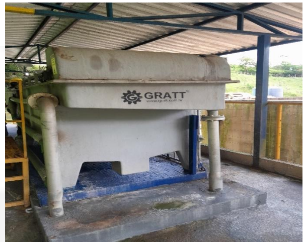
Figura 02: Estação de Tratamento de Efluentes (ETE) - Flotador etapa físico-química.
