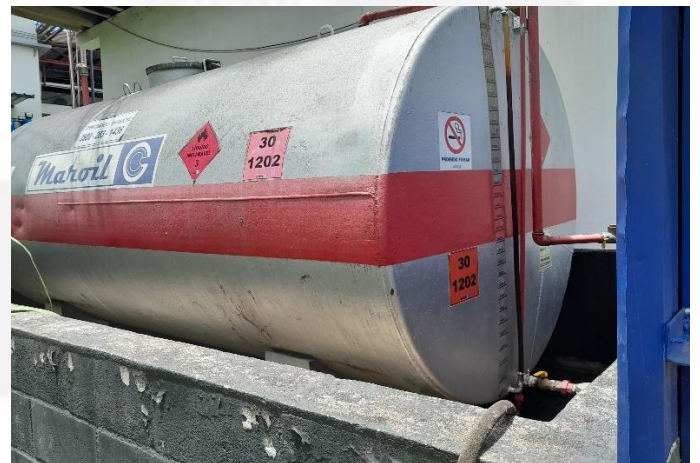
Figura 06: Tanque aéreo de óleo diesel – 14 m 3
