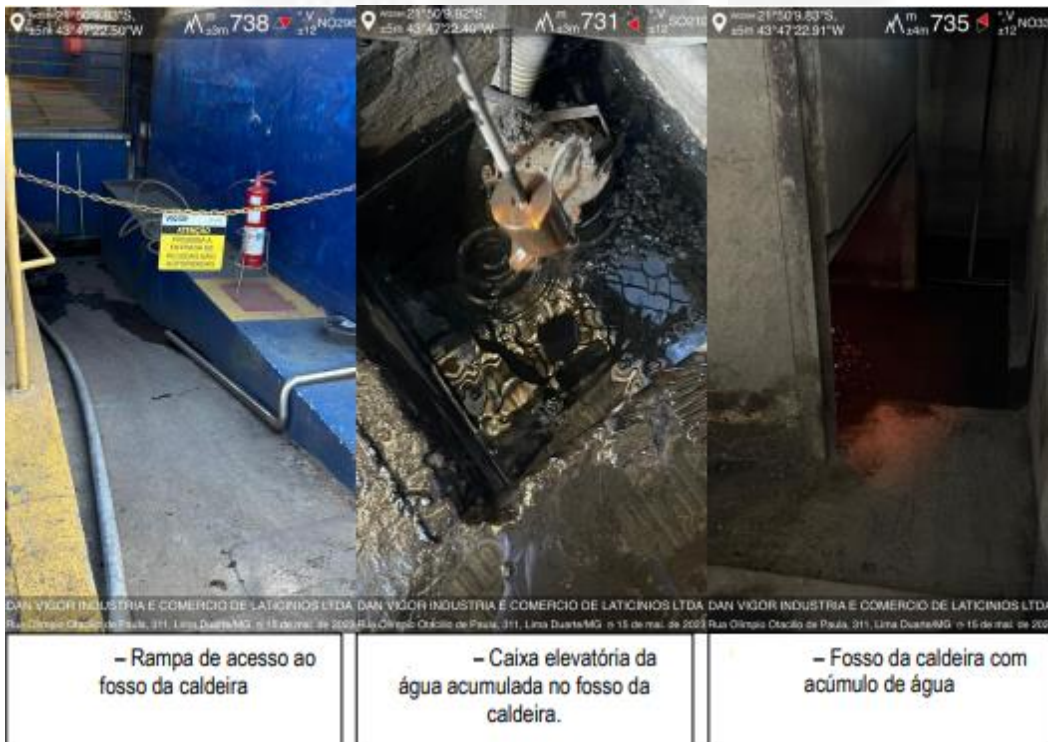
Imagem 02: Local onde foi verificado ocorrência de acúmulo de água.
