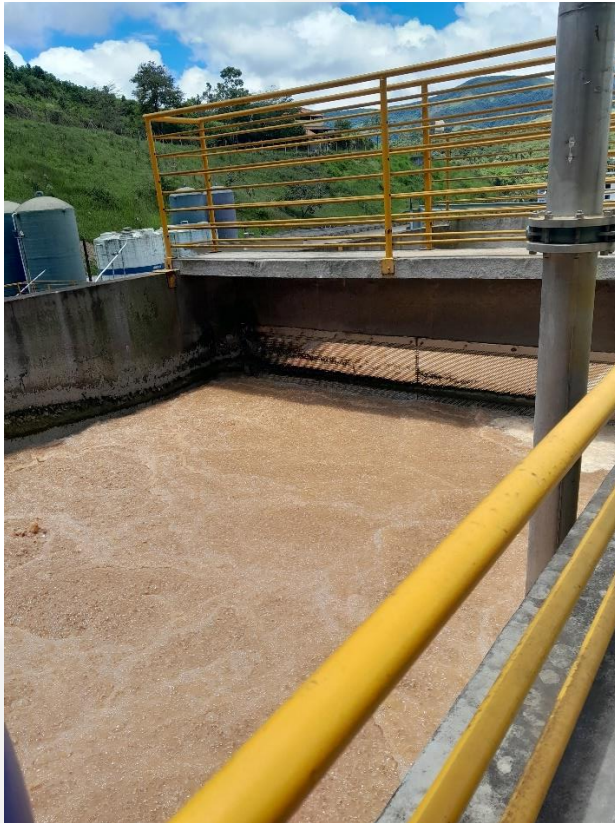
Figura 03: Estação de Tratamento de Efluentes (ETE) – Reator biológico
