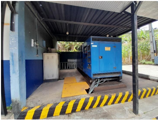
Figura 07: Gerador de energia
