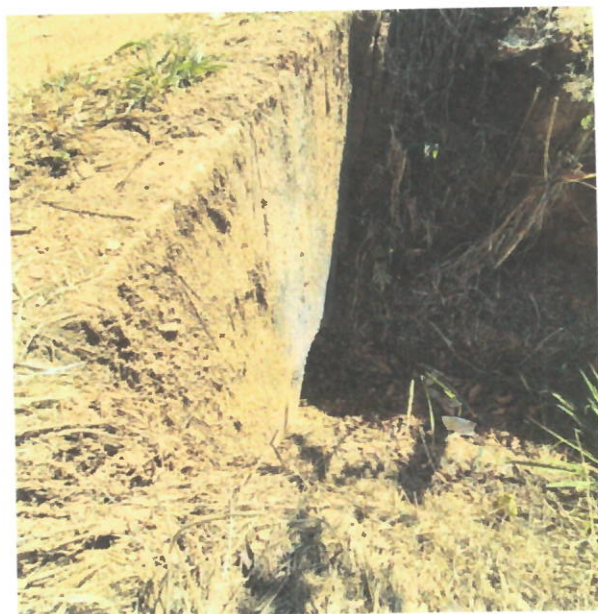
Figura 29: Colmeia em sistema de drenagem. Fonte: arquivo SEMA, .
