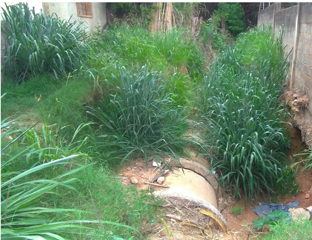
Figura 04: Foto realizada no dia da vistoria 28/10/2022.
