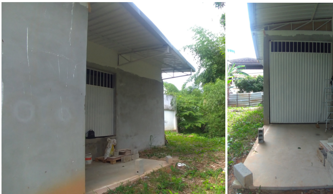
Foto 02 e 03: Registro fotográfico realizado na data de 28/10/2023, demonstrando a ampliação não autorizada.
