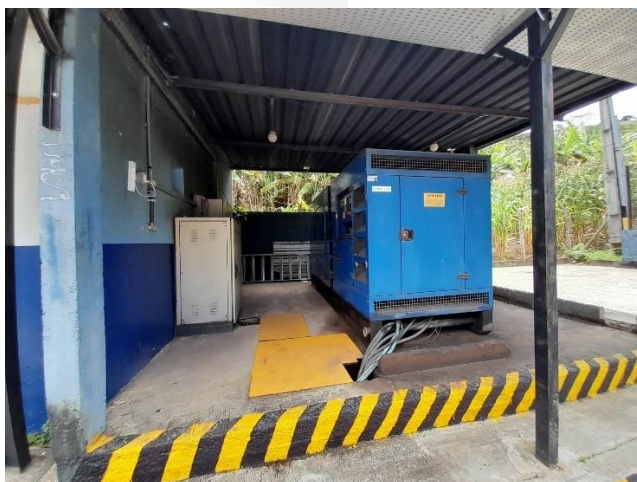
Figura 07: Gerador de energia
