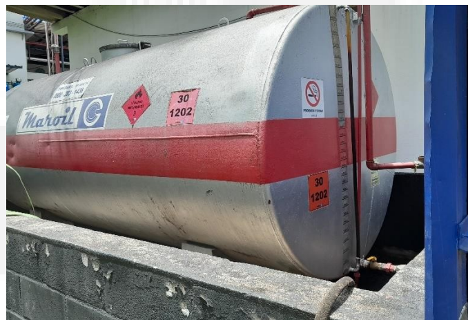
Figura 06: Tanque aéreo de óleo diesel – 14 m 3
