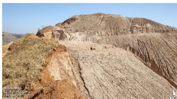
Foto 25: Taludes com sulcos erosivos instalados.
