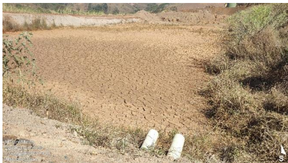
Foto 49: Bacia de contenção de sedimentos. Ponto final do sistema de drenagem.
