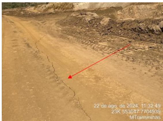
Foto 53: Bacia de decantação que apresenta fissura (seta vermelha) em dique lateral.
