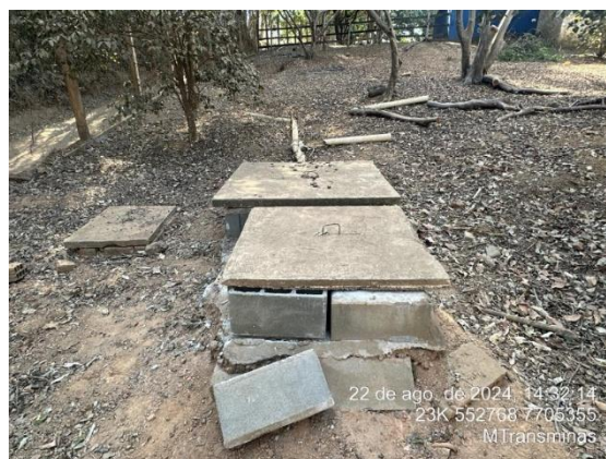
Foto 74: Biodigestor associado à portaria.
