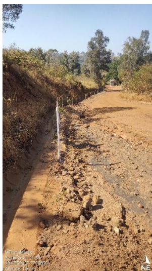
Foto 55: Canaleta em concreto construída em via de acesso. Nota-se que a o escoamento pluvial faz-se no acesso, promovendo erosão e transporte de sedimentos.
