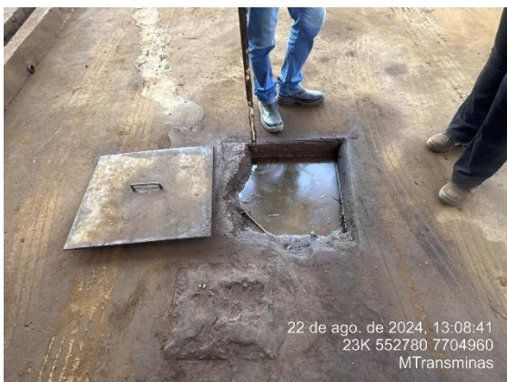
Foto 81: Caixa de passagem localizada na oficina mecânica.
