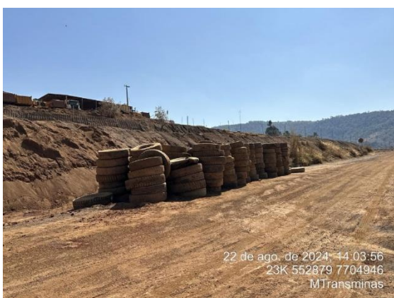
Foto 71: Pneus inservíveis dispostos em via não pavimentada.
