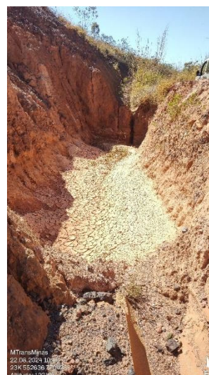
Foto 28: Bacia de contenção alimentada por canaletas em concreto. Destaca-se a presença de sedimentos na canaleta.
