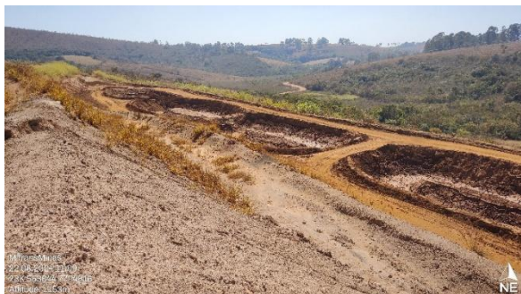
Foto 51: Bacias de decantação e de recirculação de água da água de processo.
