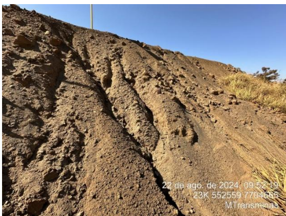
Foto 17: Vista aproximada dos sulcos que se formam nos taludes das pilhas de rejeitos.
