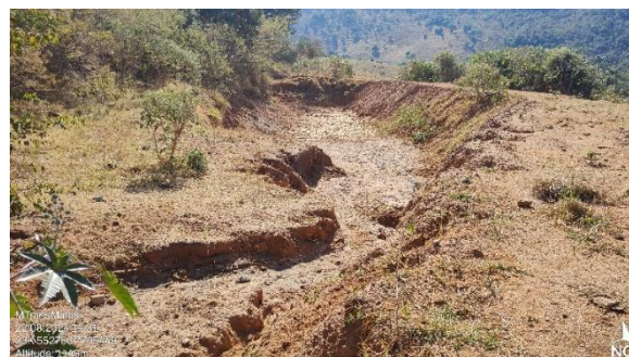
Foto 58: Bacia de contenção que serve o sistema de drenagem do acesso próximo a portaria do empreendimento.
