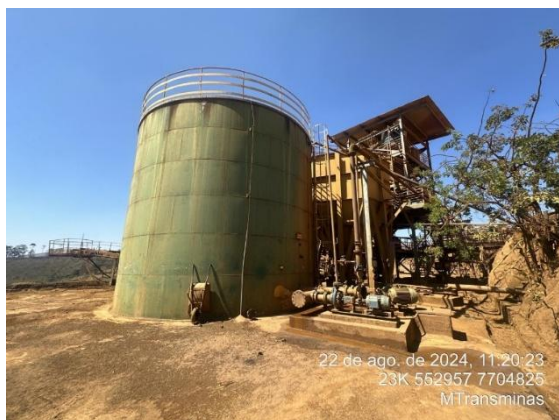
Foto 11: Tanque que armazena água a ser utilizada no processo da UTM a úmido.
