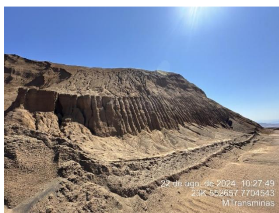
Foto 20: Pilha de rejeito com processos erosivos e carreamento de material.
