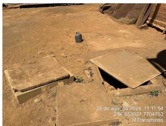
Foto 72: Biodigestor associado ao banheiro da UTM a úmido.
