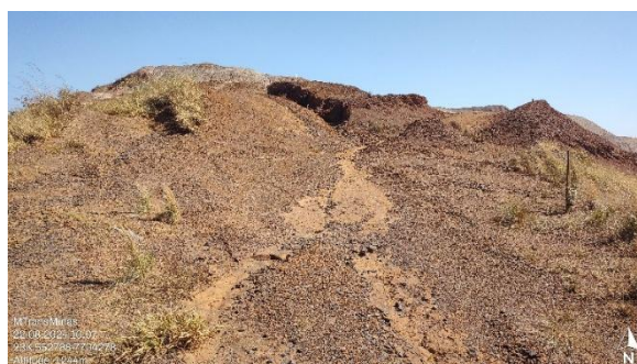
Foto 32: Erosão laminar e concentrada (em sulcos). Não há medidas de controle e mitigação nesta área.
