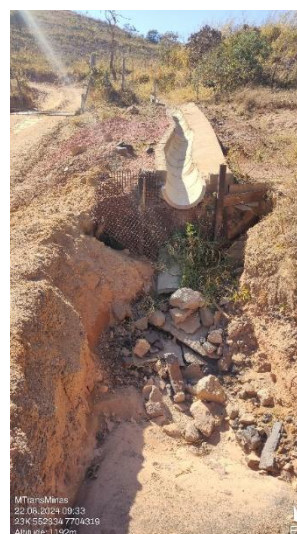
Foto 26: Canaleta em concreto desembocando em solo. Porção sudoeste, fora da ADA.
