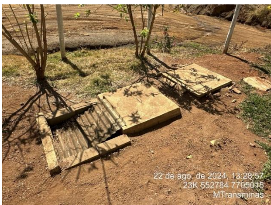
Foto 73: Biodigestor associado ao refeitório.
