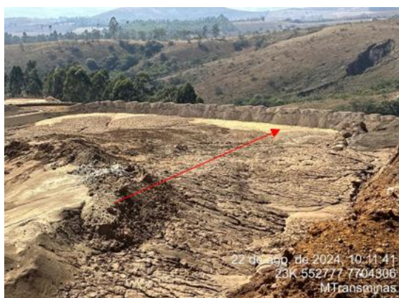
Foto 37: Nas laterais do pátio de disposição de sedimentos há leiras de contenção, indicadas com a seta vermelha.
