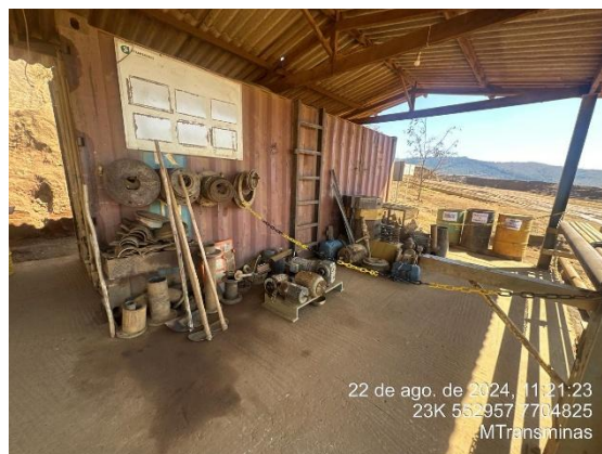
Foto 78: Seta indicando mancha de óleo na oficina industrial (a qual foi informado não ocorrer atividades que utilizem tal insumo).
