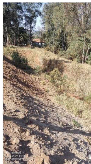
Foto 56: Caixa dissipadora de energia localizada na porção nordeste da ADA. Como percebe-se, ela não está conectada ao sistema de drenagem.
