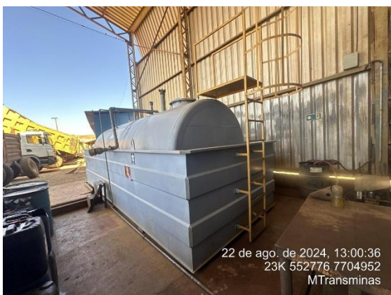
Foto 85: Tanque se localiza dentro de uma estrutura metálica, a qual possui bacia de contenção. Aparentemente a bacia não é capaz de conter a volumetria máxima de combustível (14.900m³).
