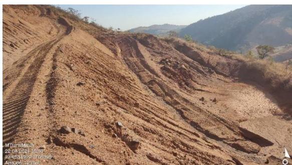
Foto 63: Taludes com sulcos erosivos localizados na porção noroeste da ADA, direcionados para bacia de contenção.
