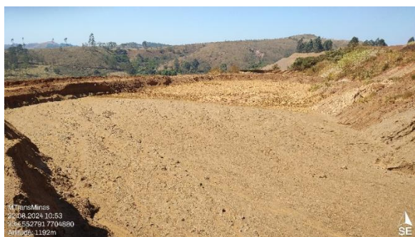
Foto 43: Caixa dissipadora de energia localizada na porção sudeste da ADA.
