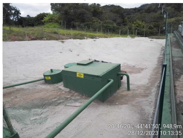
Foto 02. Sistema de tratamento de efluentes líquidos.
