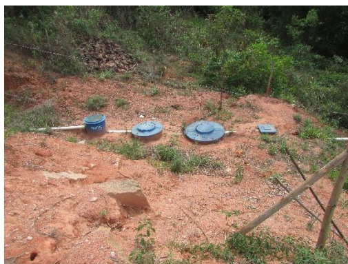
Figura 5: Sistema de tratamento de efluentes sanitários
