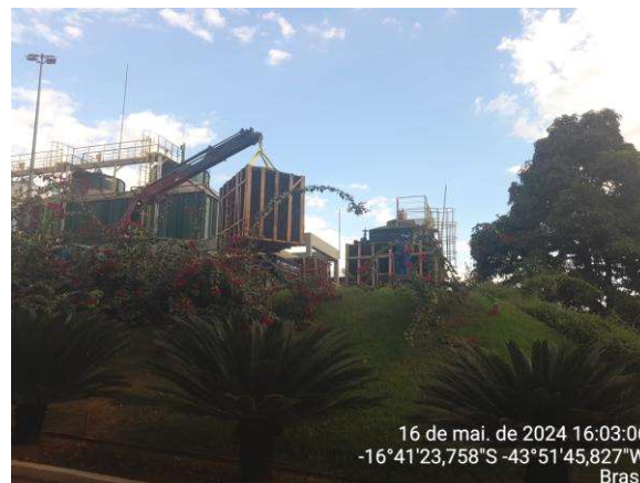
Foto 04 - Local Planta Reuso Banheiros
