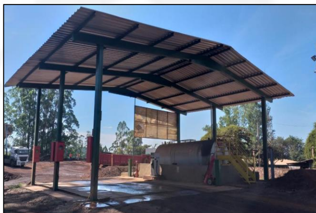
Foto 08 – Ponto de abastecimento do empreendimento (Relatório Técnico de Situação, 2022).
