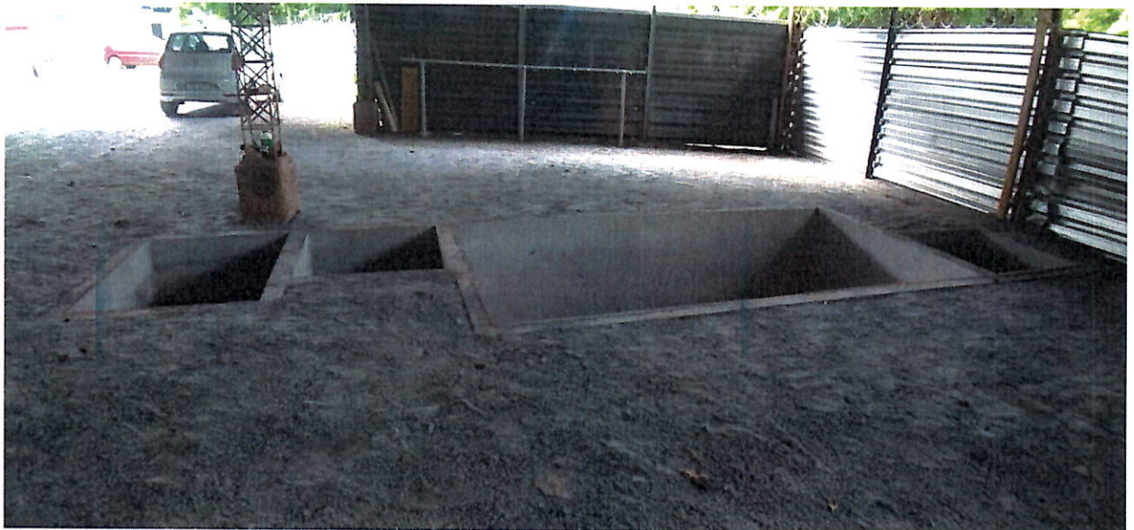
Foto 01: Foto tirada 19/11/2021 evidenciando a ETE já instalada.
