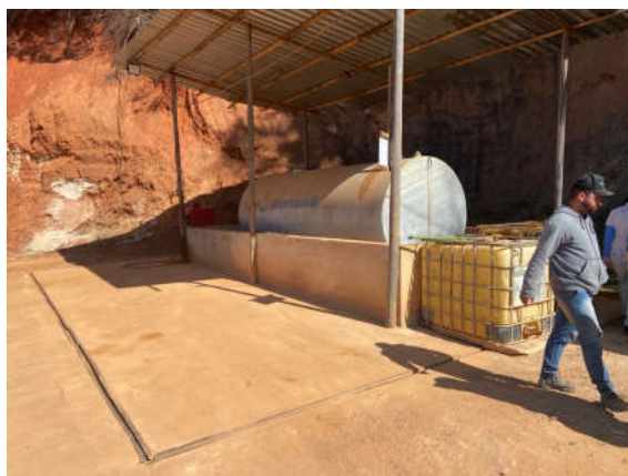
Foto 03. Ponto de abastecimento e reservatório de combustível aéreo com as medidas de controle (piso impermeabilizado, canaletas e mureta de contenção).
