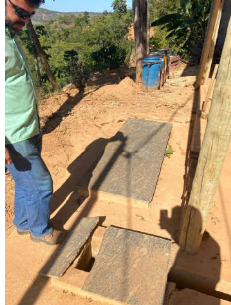
Foto 10. Caixa S&O ao fim da canaleta.
