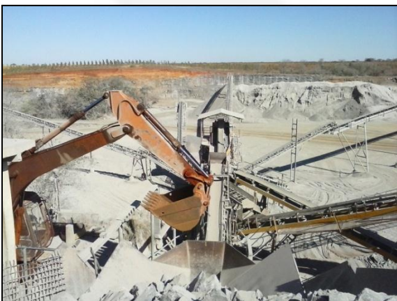
Foto 17: Área de britagem
