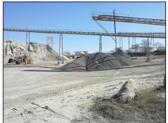
Foto 16: Área de britagem
