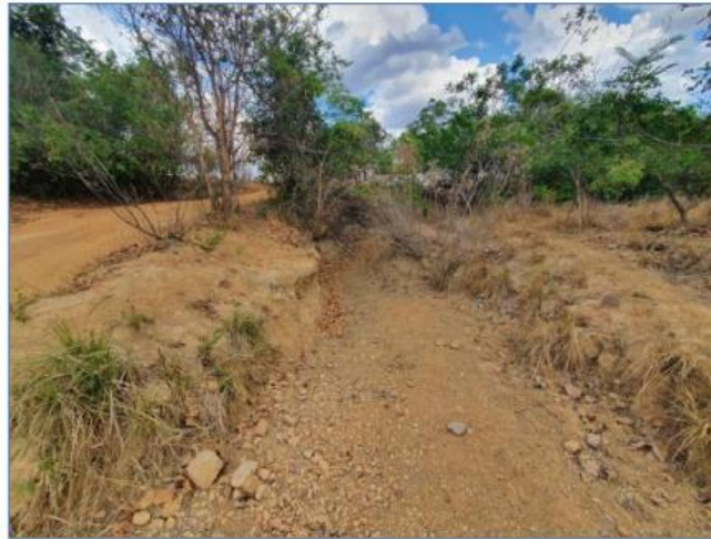
Figura 3-5 Solo erodido próximo ao Córrego Buriti
