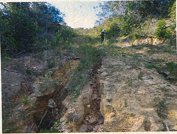
Foto 03: Estrada de acesso com processos erosivos avançados e carregamento de sedimentos ao curso d'água
