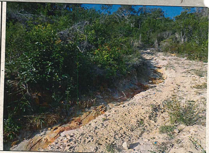
Foto 02: Estrada de acesso com processos erosivos avançados e carreamento de sedimentos ao curso d'água
