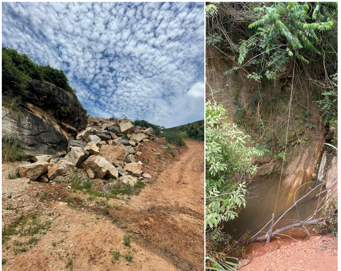
Figura 6: Fotos das intervenções constatadas em 19/03/2026 Rejeitos da rocha extraída e aterramento e interrupção d
