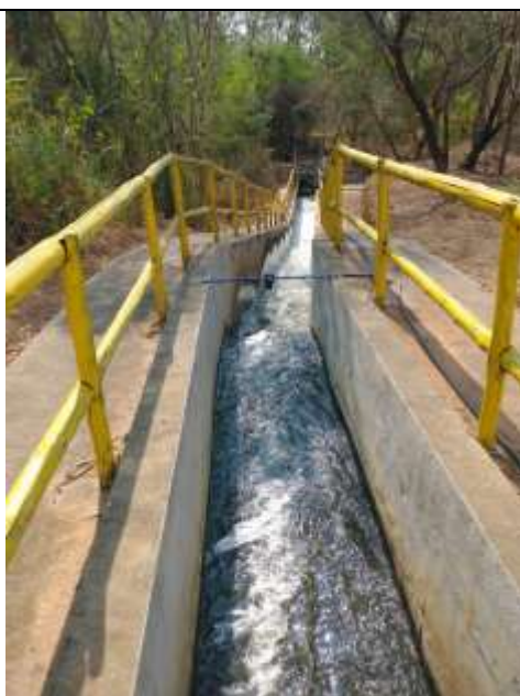
Foto 03: Canal de lançamento do efluente tratado
