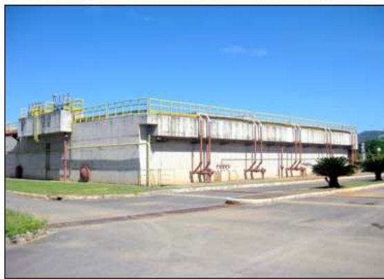
Vista do detalhe das tubulações de descarte do lodo e o sistema de amostragens do lodo.
