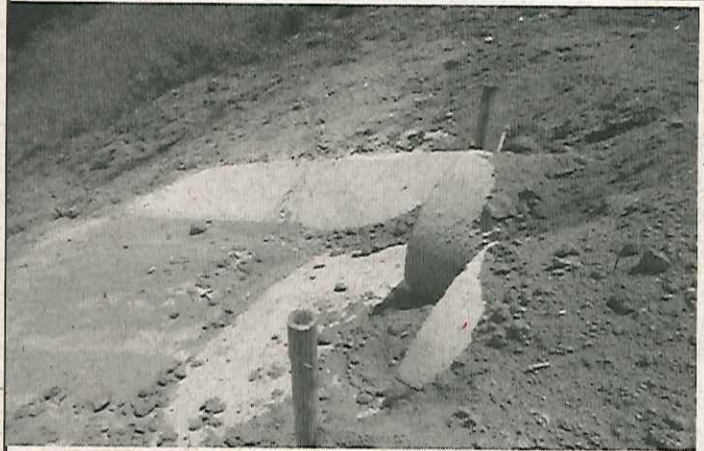
Foto 04: entrada agua no vertedouro- precisa de retificação com cimento acima das manilhas
