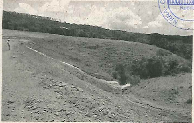
Foto 02: Talude a jusante- precisa ser melhor compactado e com plantio de gramíneas para segurar o aterro.
