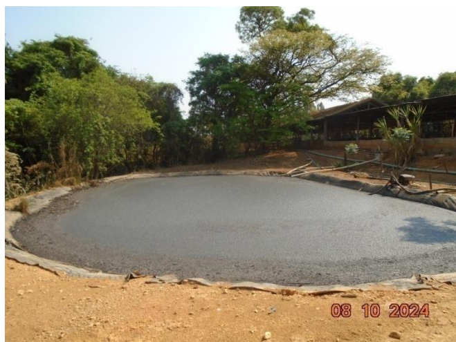
Figura 03: Sistema de tratamento de dejetos
