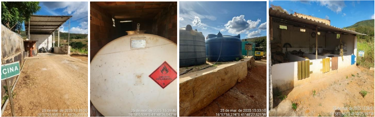
Fotos 16, 17, 18 e 19 – Oficina mecânica; tanque de armazenamento de Diesel; caixas d'água; geradores; compressor; baias de resíduos sólidos.
