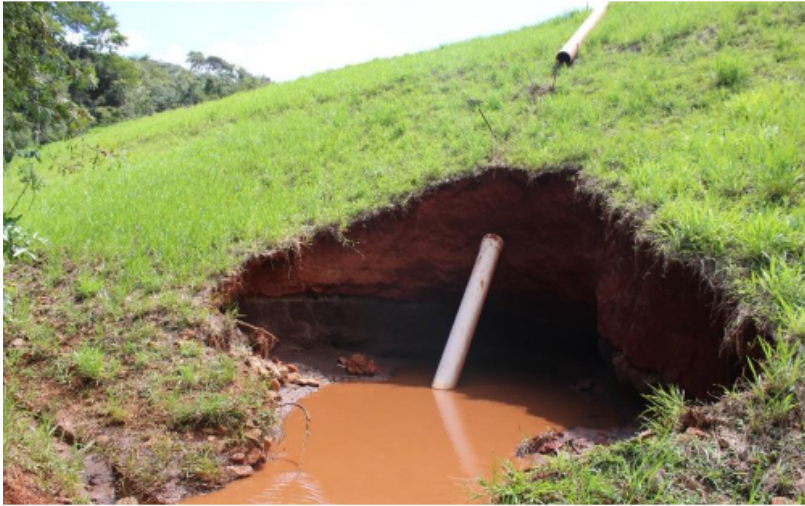
Figura 1: Erosão no sopé do talude da barragem
