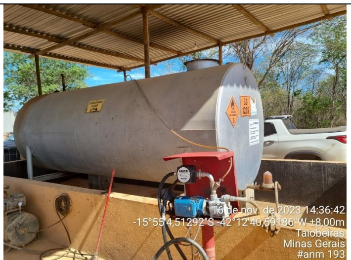
Figura 04: Ponto de abastecimento e Galpão (oficina mecânica, vala de troca de óleo e depósito de resíduos contaminados). Fonte: URANM, 2023.
