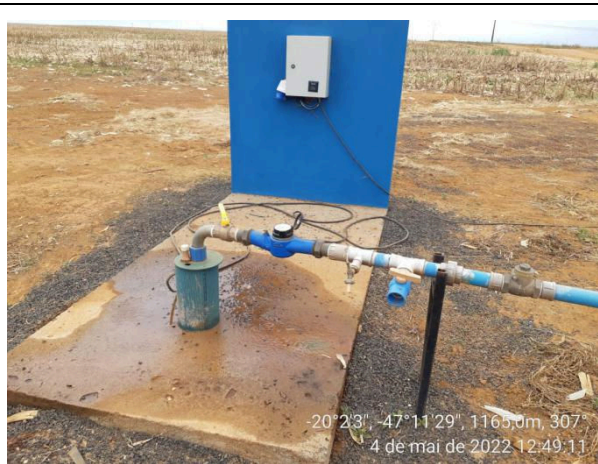
Foto 5. Captação de água subterrânea
