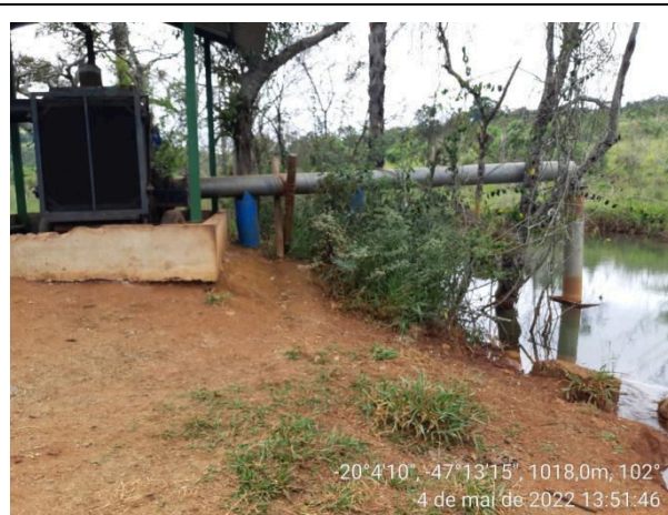
Foto 6. Captação de água superficial
