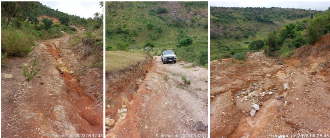
Fotos 4, 5 e 6 – Acessos internos com ruim trafegabilidade.
